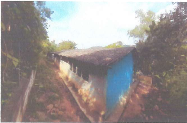
Foto 1: Los cinco salones de clases están techados con duralita, la cual tiene mucho tiempo, por lo que se encuentra en malas condiciones.
