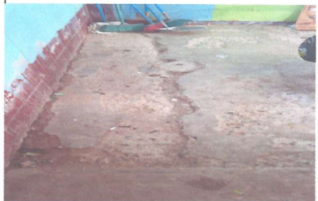
Foto 2: El piso de dos salones de clases se cuestra en mal estado, presentan algunos hundimientos, lo que provocan que los alumnos se precipiten.
